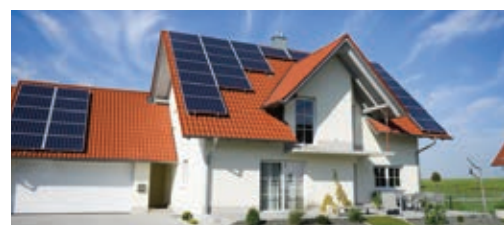
Fig. 9 – Panouri solare pe acoperișul unei locuințe
