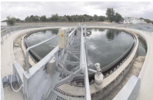
Fig. 10 Stația de epurare
