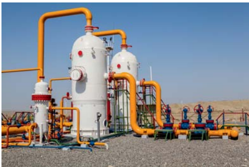
Fig. 12 Stație de extracție și pompare a gazelor
