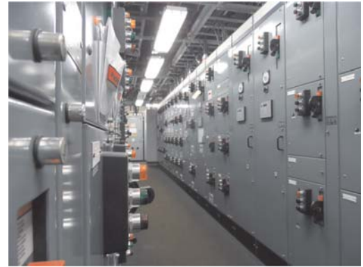
Fig. 18 Centrală electrică – interior cameră de control
